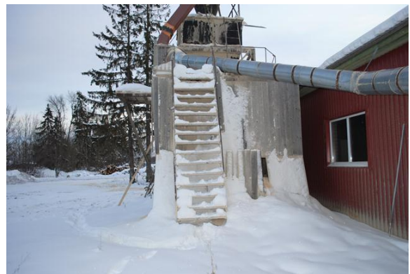
Saepurupunkri hooldamiseks tuli ronida mööda treppi platvormile, kuid talvel oli trepil liikumine töötajate jaoks ohtlik.
