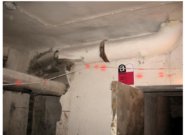
Asbestiga isoleeritud soojaveetoru renoveeritavas hoones. Seinal on materjali asbestisisaldusest teavitav hoiatusmärk.
